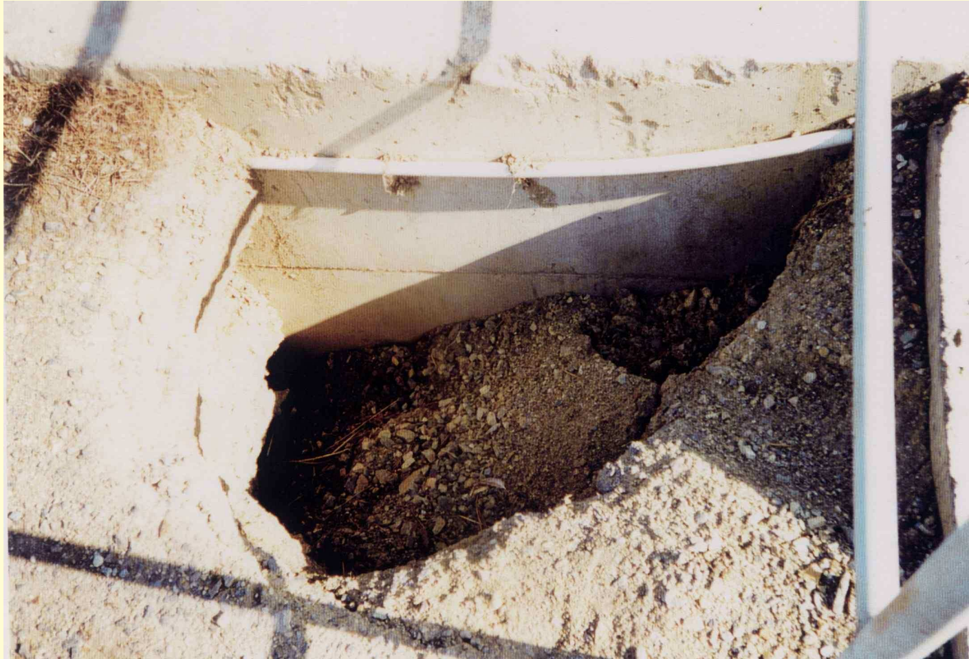
Fontis dans remblai de l'ouvrage
