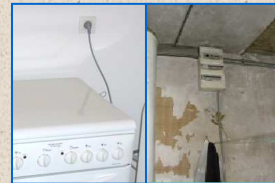
Réseau électrique descendant, ré-hausse des prises
